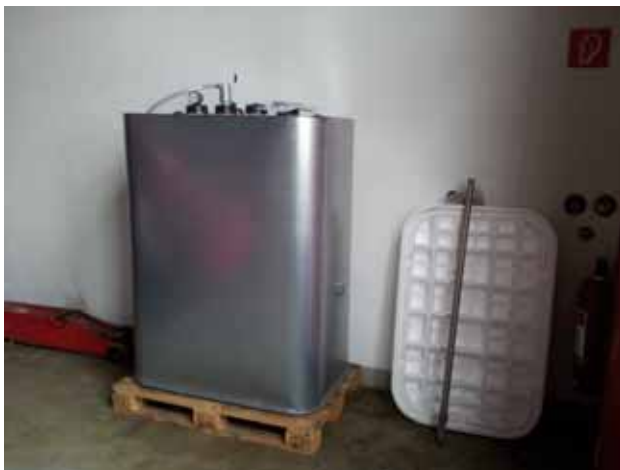
1000-Liter Dieseltank – Hausanlage Damit sind wir für Katastrophenfälle gerüstet
